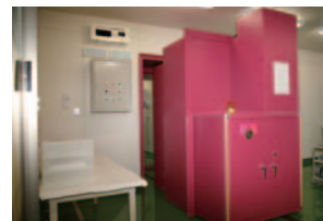
サイクロトロン遮へい装置
